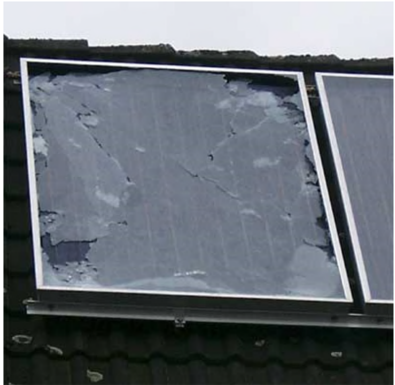
oben: Schaden durch verzogenen Rahmen; ½ Jahr nach dem Einbau barst die Glasabdeckung durch Spannung. Passanten können durch herabfallende Glasscherben verletzt werden.
